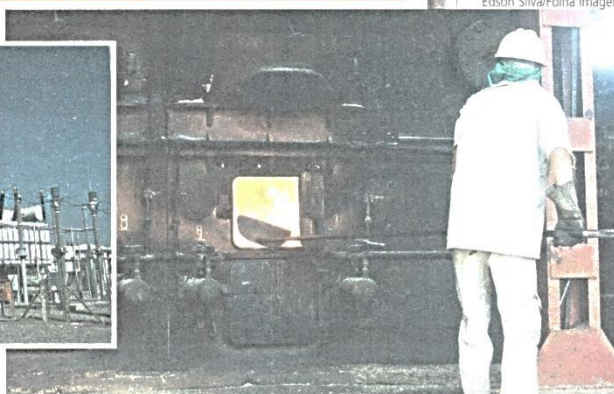
Caldeira da Usina São Francisco, Sertãozinho/SP, 2008.
