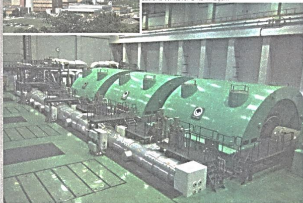
Turbinas a vapor, reator atômico, da Usina de Angra dos Reis/RJ, 2007.
